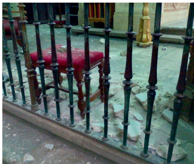
Figura 4. Parroquia de la Encarnación de Santa Fe. Desprendimiento de revestimientos. Se puede observar que son de un espesor mayor, lo que es habitual en estos bienes.
