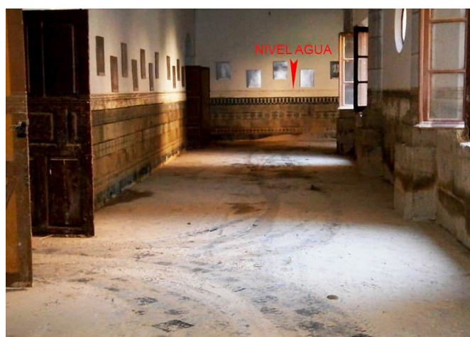
Figura 5. Convento de San Francisco. Acumulación de lodos en paramentos y solados de piedra y daños en los revestimientos de paredes, pinturas y carpinterías de madera.
