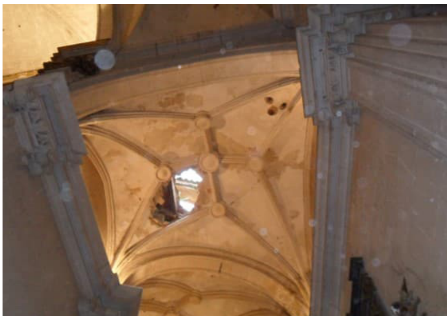
Figura 6. Antigua colegiata de San Patricio de Lorca. Daños observados a simple vista desde el interior. Agujero en bóveda de doble curvatura.
