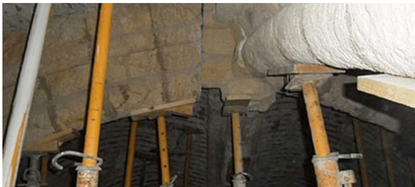
Figura 1 1 . Foto del interior de la Torre del Espolón del Castillo de Lorca, tras el terremoto de 2011.
