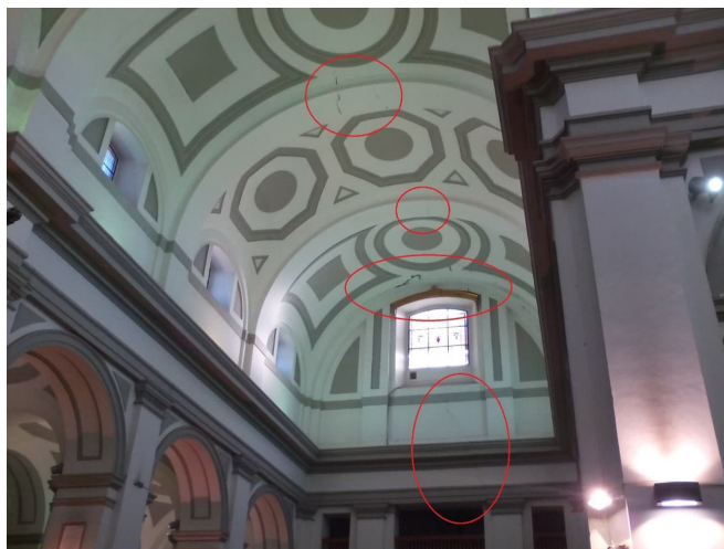
Figura 7. Parroquia de la Encarnación de Santa Fe. Fisuras longitudinales en revestimientos de cúpulas, bóvedas, arcos y paramentos verticales.
