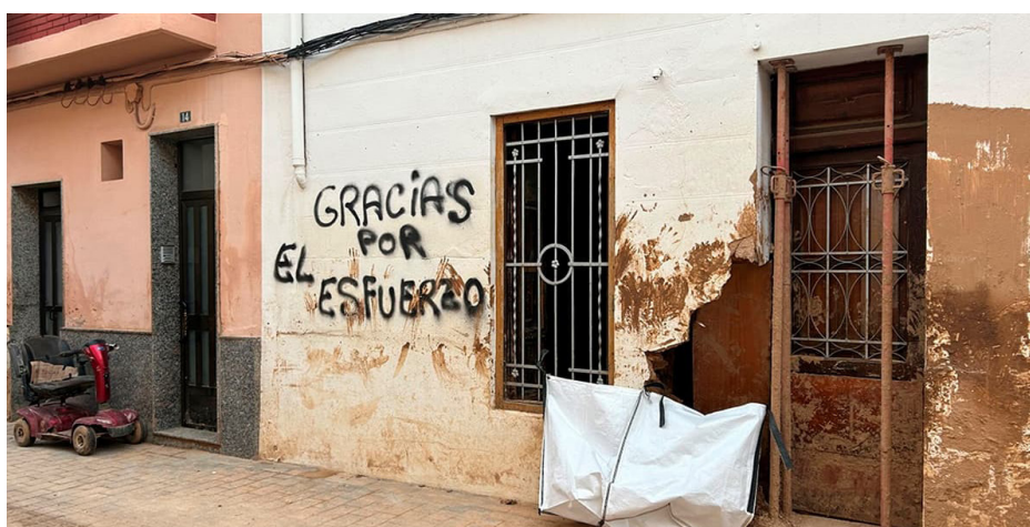
Foto 5. Fachada de vivienda inundada en Paiporta.
