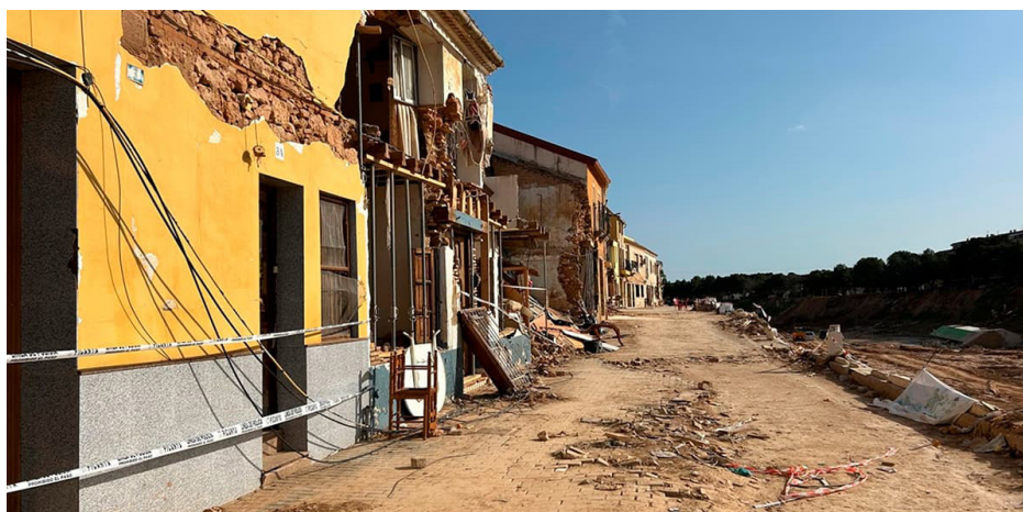
Foto 6. Viviendas afectadas en Picanya, junto a la rambla del Poyo. Fuente: Consorcio de Compensación de Seguros.
