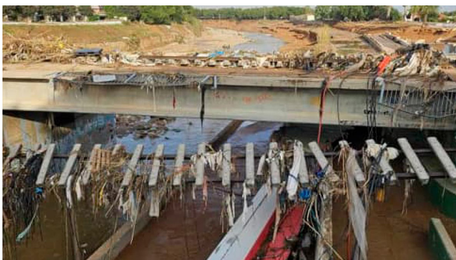
Image 9. Damage to a Metrovalencia viaduct over the Poyo Ravine. Source: Consorcio de Compensación de Seguros.
