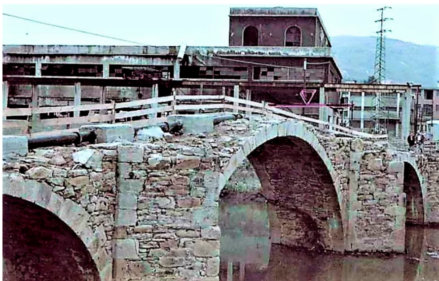
Figura 3. Puente de Mercadillo, en Galdakao, tras las inundaciones de agosto de 1983. Marca de la altura alcanzada por el agua.
