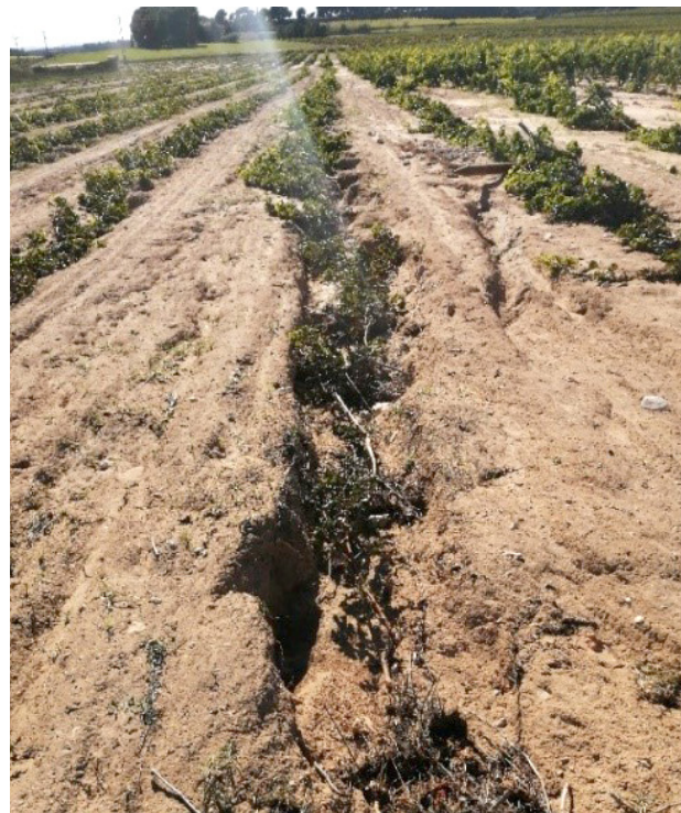
Fotografía 6. Plantación en espaldera abatida por la fuerza del agua, descalzando el terreno con presencia de raíces desnudas.
